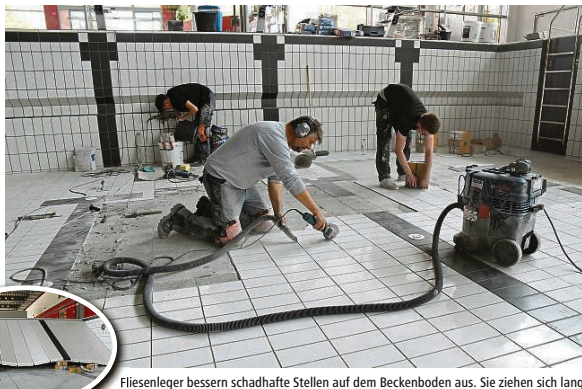
Fliesenleger bessern schadhafte Stellen auf dem Beckenboden aus. Sie ziehen sich lang über die Fläche bis unter den Hubboden (Foto links). Foto: Ulrich Gösmann
